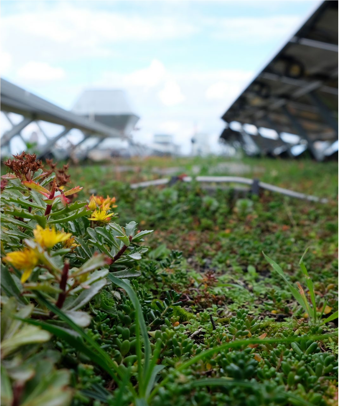
Die Solaranlagen auf den Dächern der Friedrich-Ebert-Stiftung in Berlin produzieren jährlich rund 92.000 kWh Strom, decken etwa 8 % des Energiebedarfs und sparen 54 Tonnen CO 2 ein. Das nachhaltige Projekt verbindet Photovoltaik mit Dachbegrünung.
